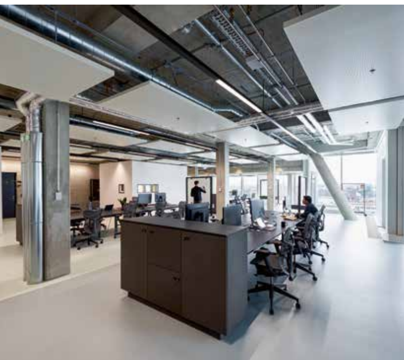
建筑的水墙和建筑设备在办公室里依然可见
